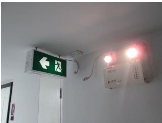
รูปภาพที่ 3.19 ระบบไฟฟ้าแสงสว่างฉุกเฉิน
