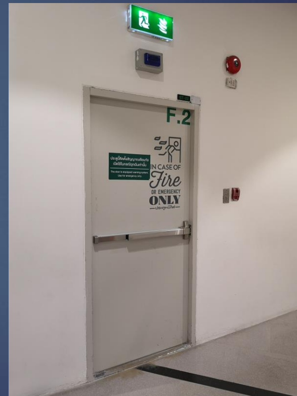
FIRE DOOR SEAL
